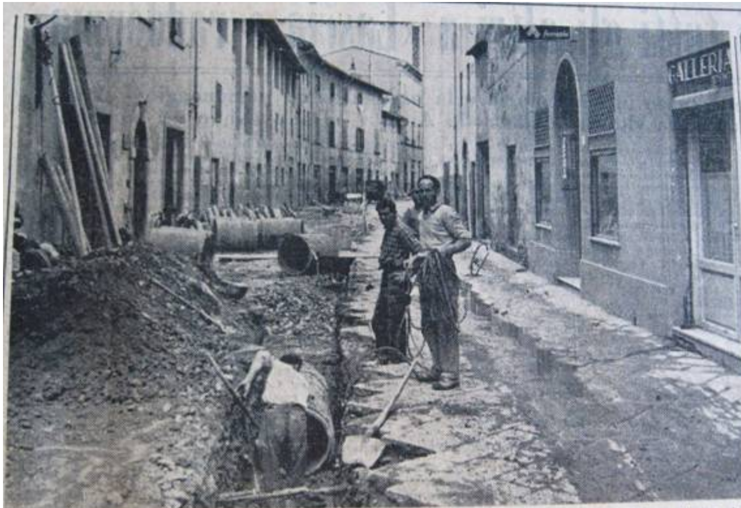
Un aspetto di via dei Tintori dove sono in corso lavori per una nuova fognatura che dovrebbe eliminare il grave inconveniente degli allagamenti (Foto Calamai - Prato)
